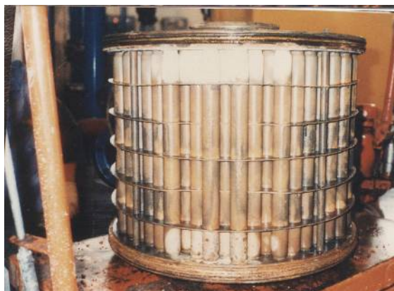
“BS21”使用・1年経過後の状態を Coolorを解体して確認する。 Scaleが完全に除去されていた。
