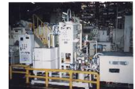
スラッジ除去による廃液削減化
